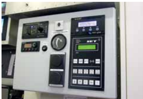
Über ein zentrales Paneel im Technikraum lassen sich alle Energiequellen schalten.
